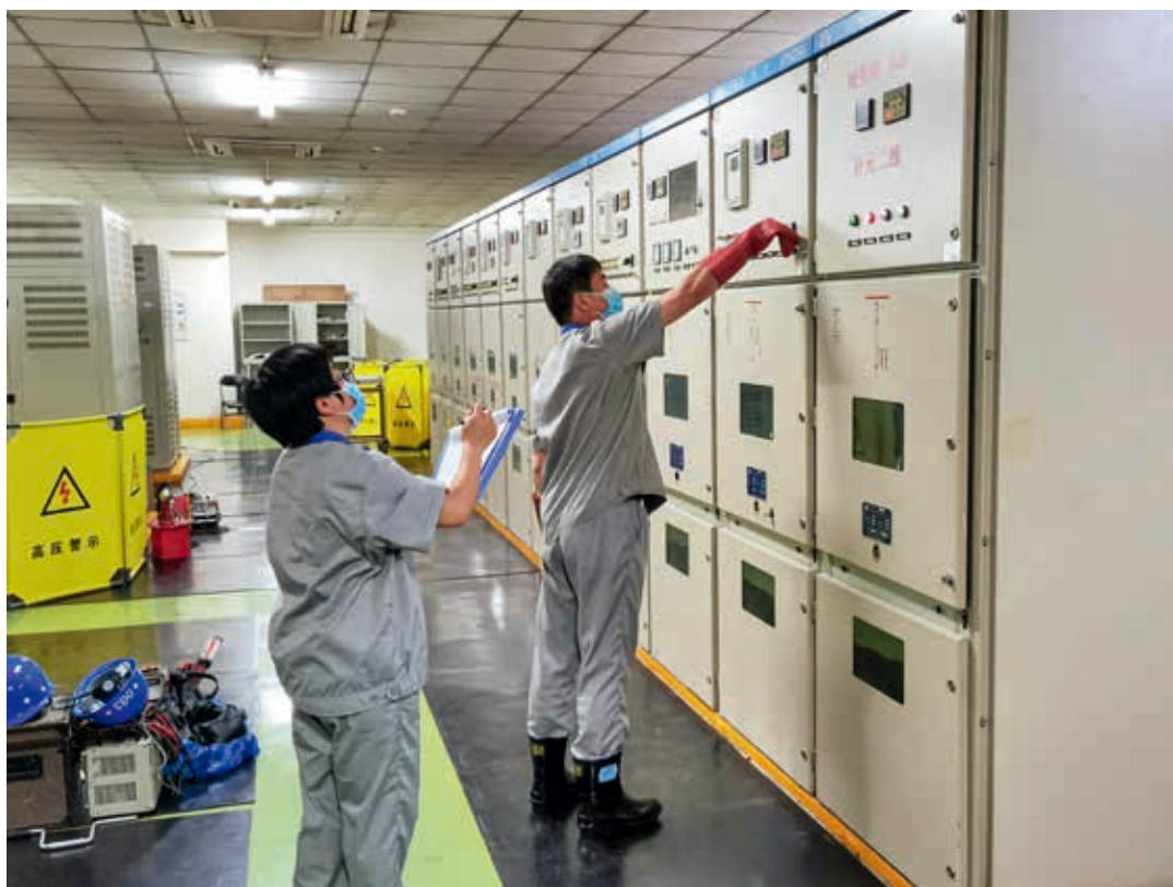
配电室倒闸试验
